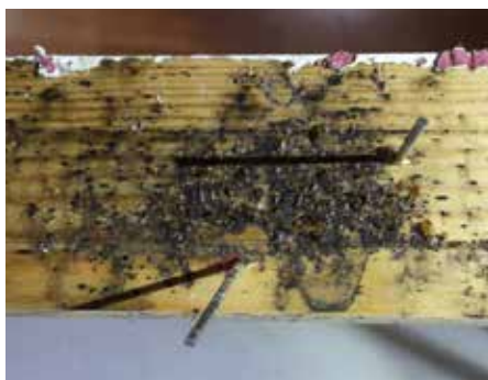
Bak denne listen fant skadedyrbekjemperne store mengde ekskrementer og rester av dyr.
